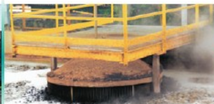
Zbrinjavanje otpadnih voda
